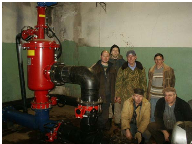
Рис. 13. Новый фильтр на водозаборной станции
