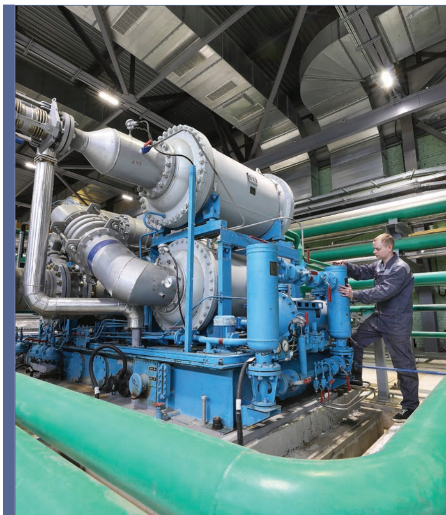
Новая криогенная компрессорная станция
